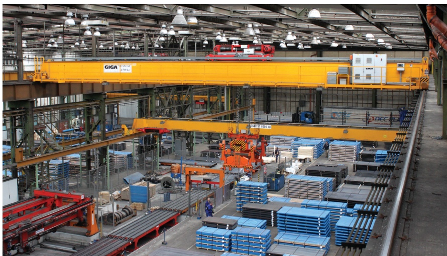
Zařábování haly ve dvou úrovních – nahoře vidíte mostový jeřáb GIGA s nosností 14,5 tuny se zavěšeným přípravkem pro transport plechů, níže je obsluze k dispozici pomocný jeřáb s nosností 8 tun
