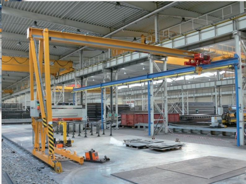
Полукозловой кран GIGA mun GPMJ 5t/9,5m Заказчик - UnionOcel, s.r.o, Прага, Место установки - производственный завод Копршивнице
