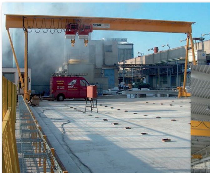
Козловой кран GIGA mun GPMJ 10t+10t/16m Место установки - Alcan Děčín Extrusions, s.r.o., Дечин
