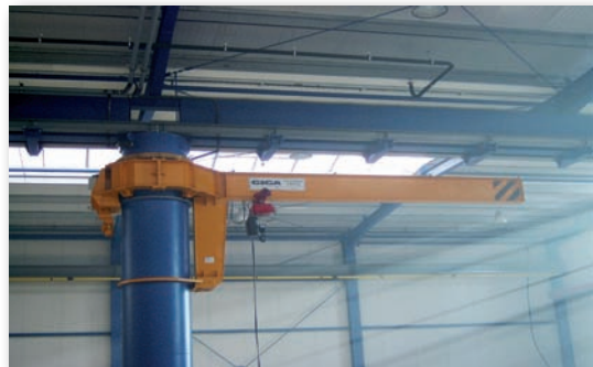
Колонный кран GSOJ 2t/6m на колонне цеха
