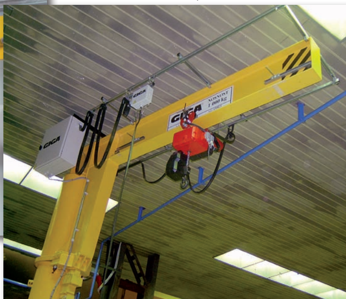
Электрический цепной тельфер CH3 1000.5-JE, установленный на колонном консольном кране GIGA mun GSOJ 1т/3,25т
