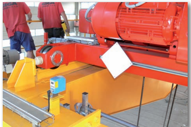
Мостový jeřáb GDMJ 12,5t/27,9m, vybavený pozicováním kladkostroje Místo instalace: Presbeton, s.r.o., Olomouc
