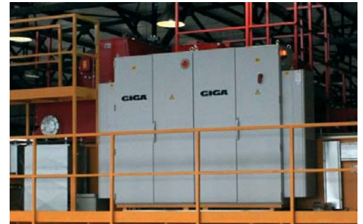
Hlavní elektrický rozváděč
